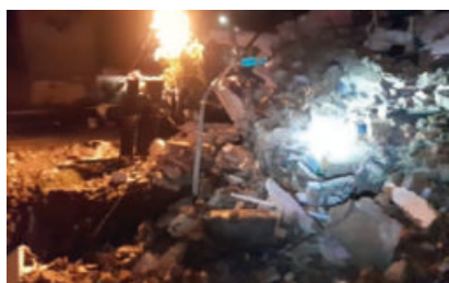
EN ZAPOPAN, Jalisco, se derrumbó la fachada de una casa de dos pisos.
