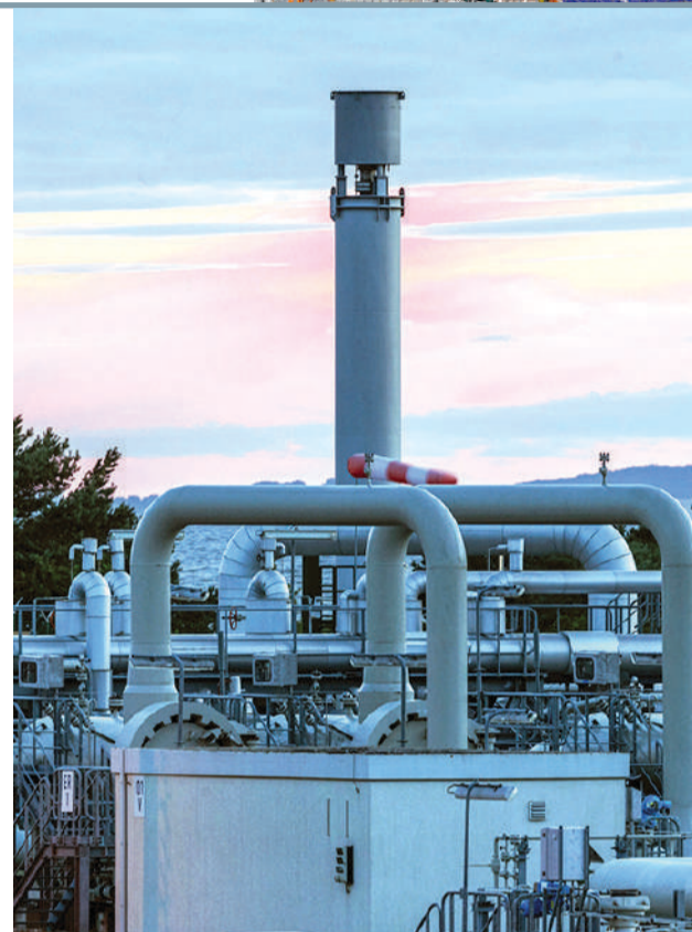
EL GASODUCTO NORD STREAM 1, el principal distribuidor a Alemania, en la terminal de Portovaya, ubicada en Leningrado, Rusia.
