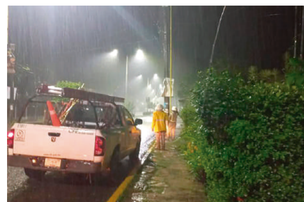
ELEMENTOS de la CFE atienden reportes de falla en el suministro en las entidades afectadas, ayer.
