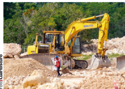
TRABAJOS de instalación de estructuras para estación del Tramo 6, el 1 de octubre.
