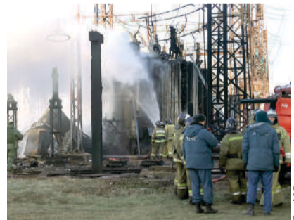
BOMBEROS tratan de contener un incendio en una base eléctrica en Donetsk, ayer.
