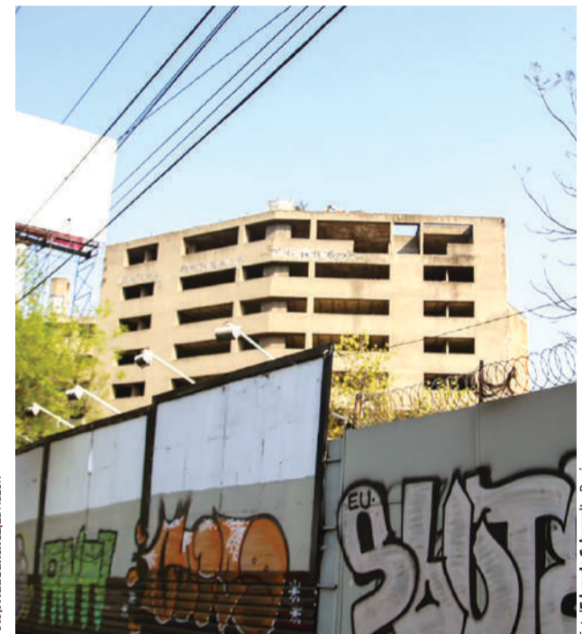
LAS BARDAS de madera y de metal que resguardan la obra lucen grafiteadas, mientras la edificación de las torres avanza.
