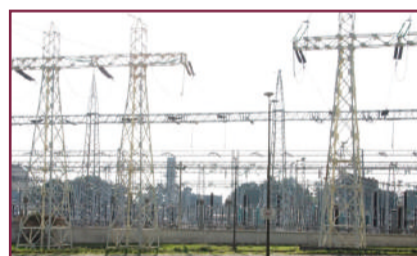
Subestaciones convencionales El conductor se encuentra expuesto, sin materiales encapsuladores.
