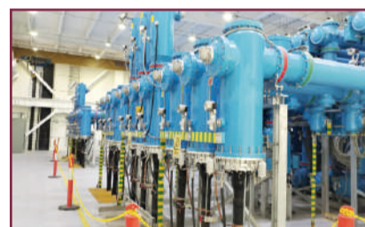
Subestación Metro-Energía El gas hexafluoruro de azufre mantiene encapsulado el conductor de energía.
