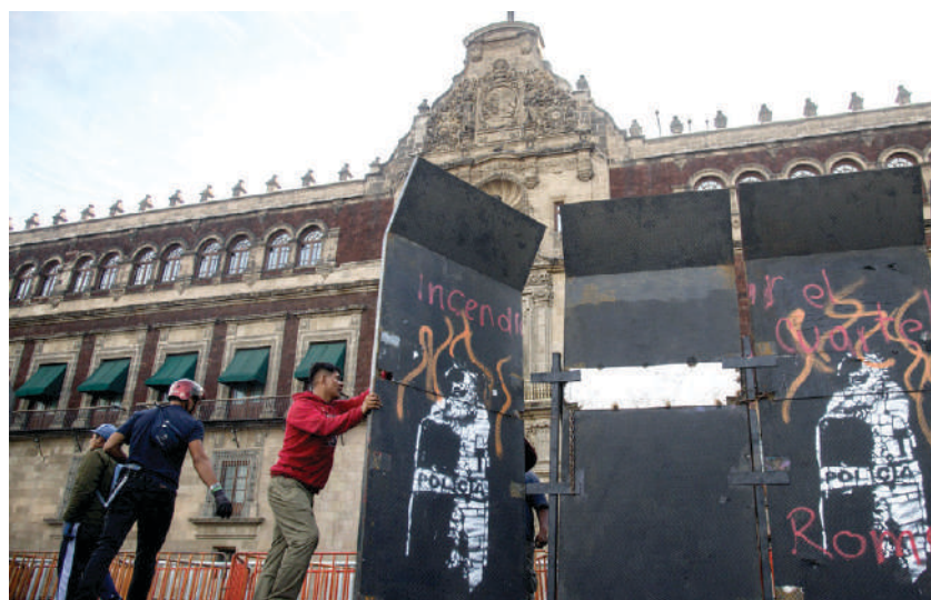
TRABAJADORES comienzan el montaje de las vallas alrededor de la Catedral Metropolitana así como en diversas zonas del centro de la CDMX, previo a la marcha del 8M.
