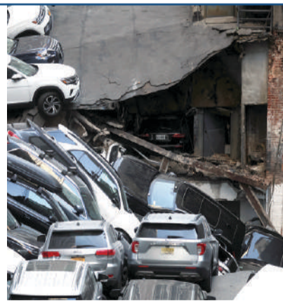
VARIOS VEHÍCULOS quedaron apilados tras el colapso del último nivel.
