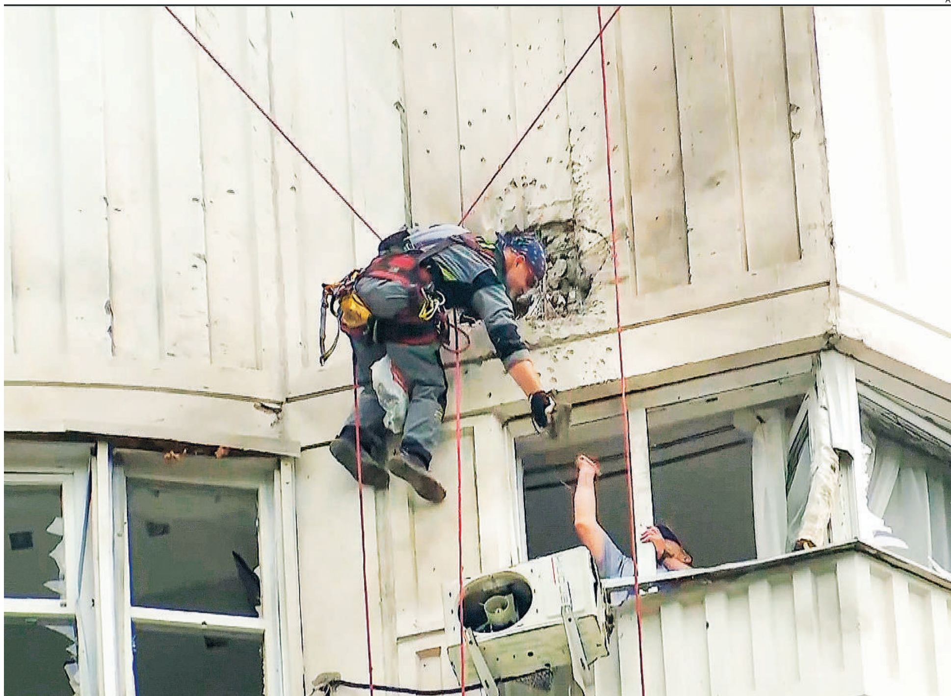
Los desperfectos en los edificios de uno de los barrios residenciales más pudientes de Moscú provocados por el ataque de los drones
