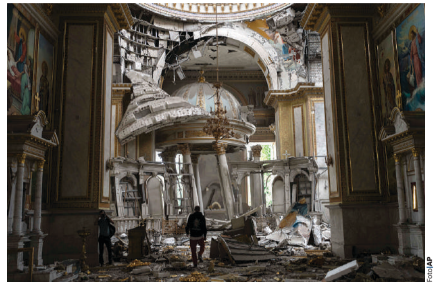
PERSONAL DE EMERGENCIA revisa los daños en la Catedral de la Transfiguración, cuyo atrio quedó destruido tras el impacto de un misil Kh-22, ayer.
