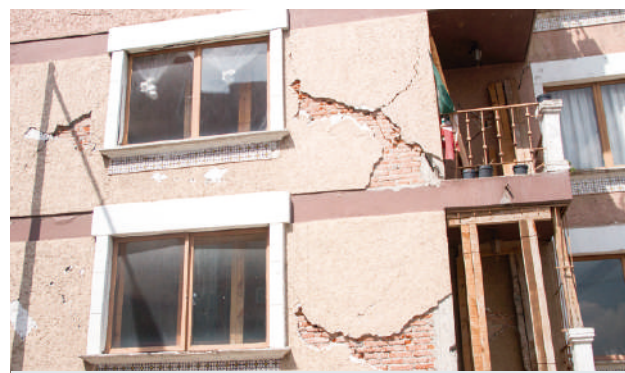
DE LOS DAÑOS por los sismos, en los últimos 5 años, las oficinas públicas son los giros más afectados con 23.4% del total, según la AMIS.
