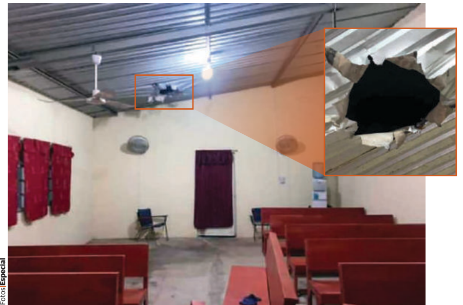
EL TECHO de aluminio de una capilla se dañó, tras los ataques con explosivos, ayer.
