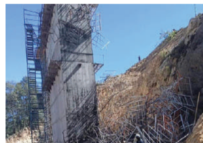
ASÍ QUEDÓ la estructura metálica de la obra, luego del derrumbe del sábado.
