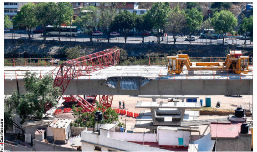
VISTA del tramo accidentado ayer, en la alcaldía Álvaro Obregón.
