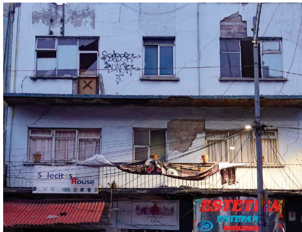
DIVERSOS inmuebles de la ciudad, particularmente en la zona poniente, han registrado daños con los microsismos, como el registrado el pasado 14 de diciembre.
