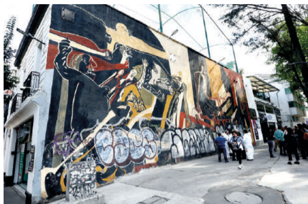
EL MURAL La guerra y la paz , ayer en el arranque de las obras.
