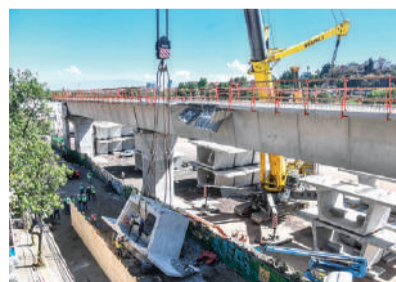
UNA DOVELA cayó el pasado 16 de enero en las obras del Interurbano.
