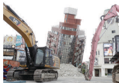
EQUIPOS iniciaron la demolición de una torre que quedó dañada, ayer, en Taiwán.
